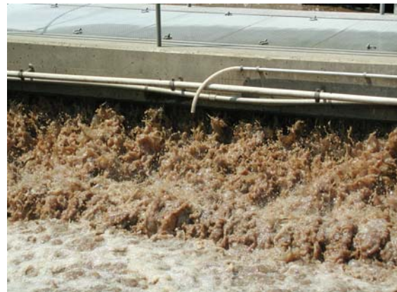
Einspeisung im Bereich der Belüftung
