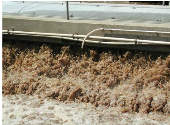
Alimentation dans la zone d'aération
